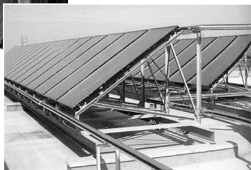
太陽集熱器設置状況
