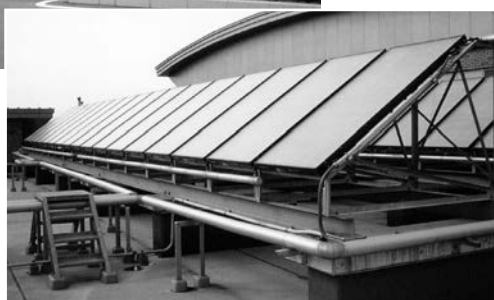
太陽集熱器設置状況
