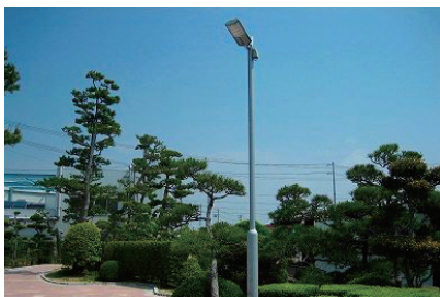
LED照明の外灯
