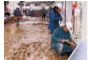
矢崎ガス機器サービス指定店等による仮設住宅のLPガス設備工事
