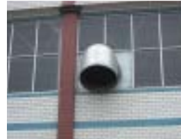
排気ダクトの改善前
