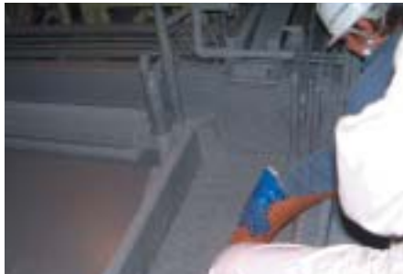
電着塗装槽の塗料入れ替え作業(浜松工場)
