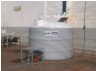
工場内に設置した雨水貯水タンク
