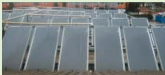
クズルク工場の屋根に設置されたソーラーパネル
