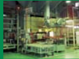
大型プレス機の下は、振動を伝えない基礎工事で近隣に配慮
