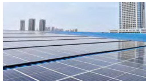
工場に設置した太陽光発電設備
