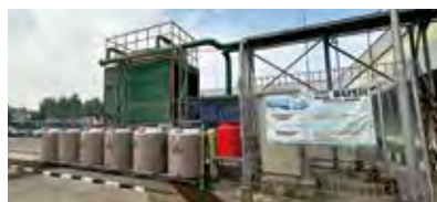
クーリングタワーと貯水タンク
